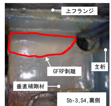
写真-2 剥離状況
