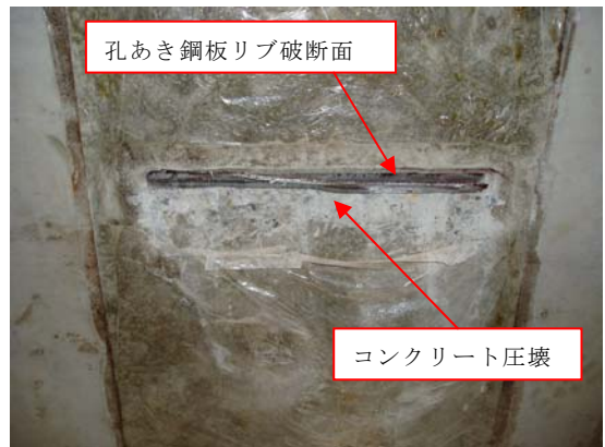
写真-1 試験体破断状況(C6 試験体)
