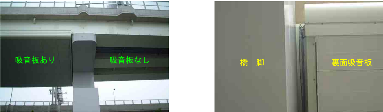
写真-1 名古屋高速道路に設置されている高架裏面吸音板の設置状況
