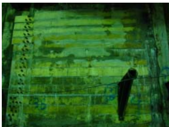
写真-2 FFU 横矢板(西欠損①)
