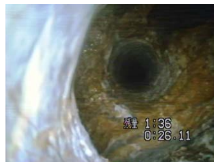
写真-1 空洞箇所における孔内観察写真
