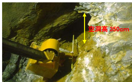
写真－2 空洞発生状況写真
