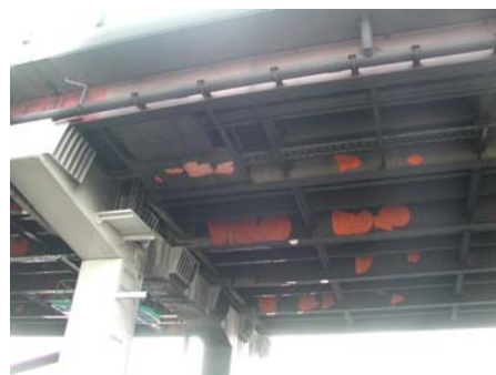
写真-1 上部工損傷状況
