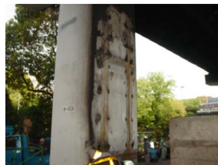
写真-2 橋脚柱部損傷状況
