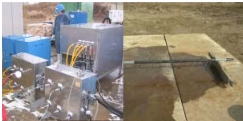
写真－1 多連ポンプと流量・圧力検出器
