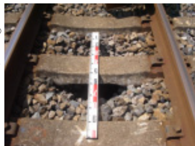
写真-1 陥没発生状況
