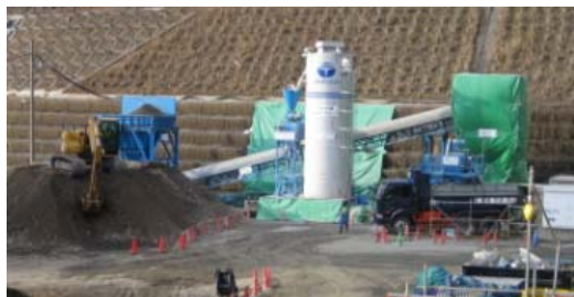
写真-1 CSG 混合プラント
