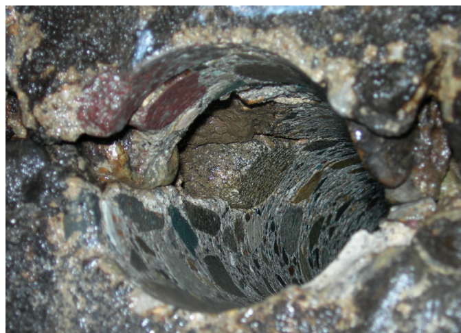
図 4-1 ボーリング孔のコンクリートの状況
