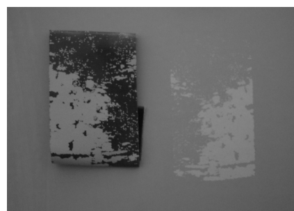
写真-2 付着性調査の塗膜剥離状況
