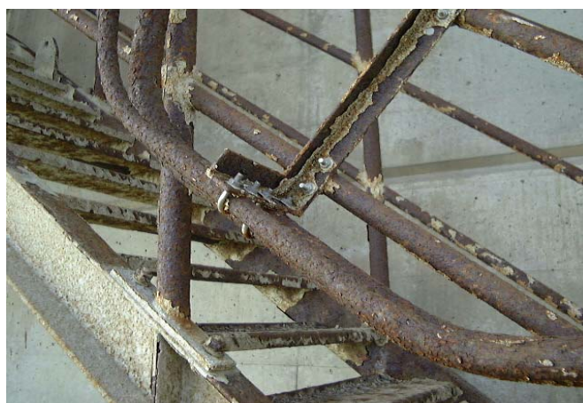
写真－1 海峡部橋梁管理路の腐食状況
