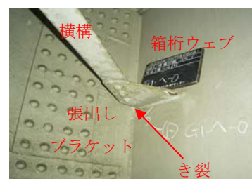
写真-1 外面側き裂位置
