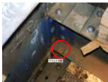
写真-2 軌条受けリベット破断
