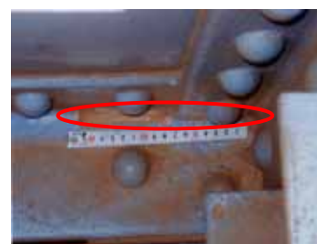
写真-3 下フランジ山形鋼亀裂
