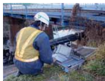
写真-5 データ収録状況
