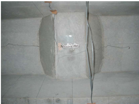
写真-4 3 枚一体供試体クラック発生状況
