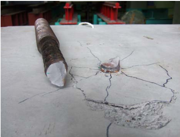
写真－２ 破断状況
