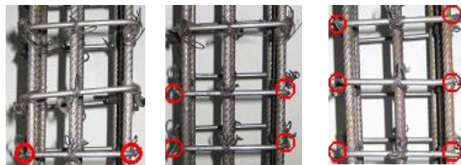
図2 帯鉄筋の切断状況
