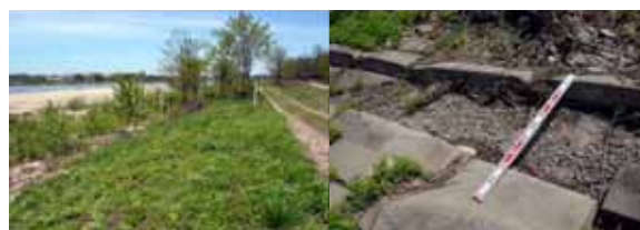
写真2 新潟県中越地震後の河川護岸の外観 緑化コンクリート 接続ブロック（隣接工区）
