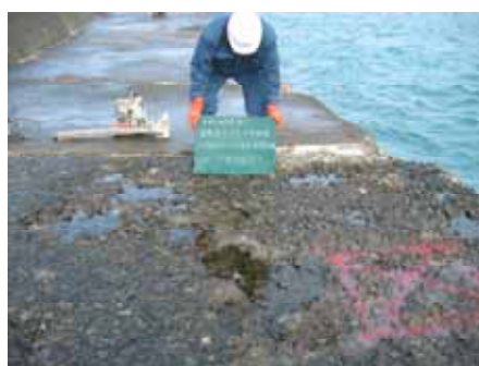
写真-1 剥離度30.9mmの剥離状況
