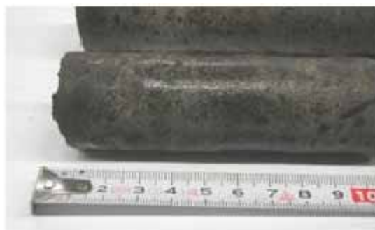
写真－３ コンクリート表面のコアの状況
