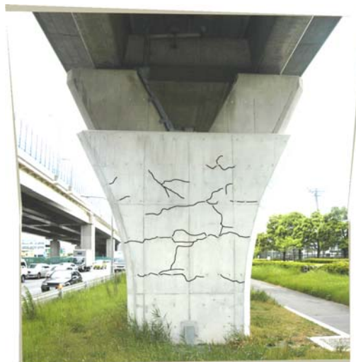
図-7 橋脚のひび割れ状況
