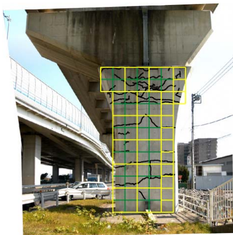
図-1 パソコンで作成されたひび割れ図
