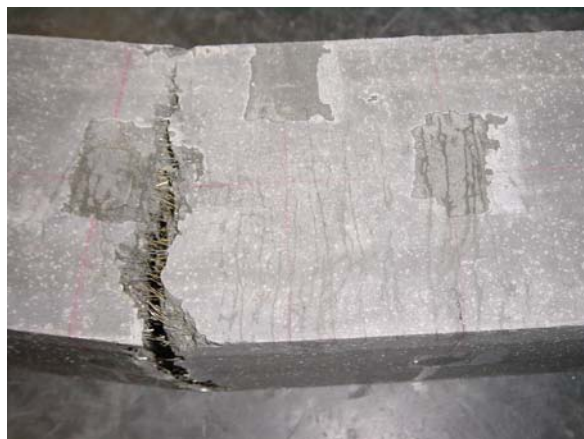
写真-2 ひび割れ状況
