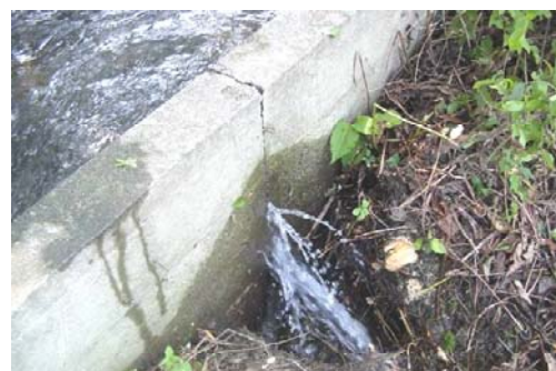
写真－1 目地損傷部からの漏水
