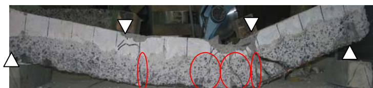
図3 劣化レベル大(引張側載荷)
