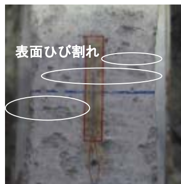
写真-1 ひび割れ状況
