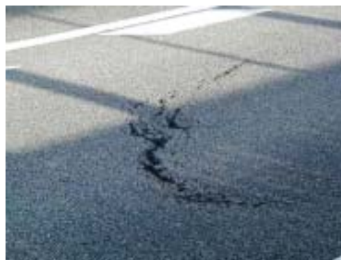
写真-1 混合物のズレによるひび割れ
