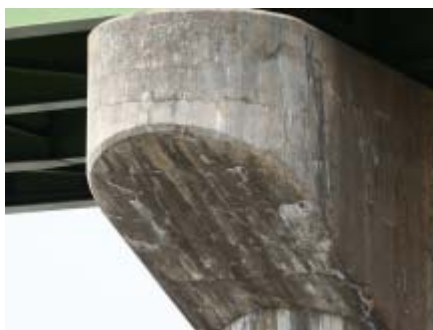
図-1 劣化度 a の事例（その 1）
