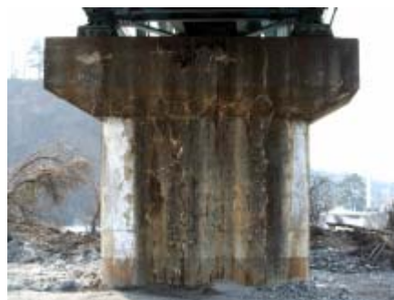
図-2 劣化度 a の事例（その 2）
