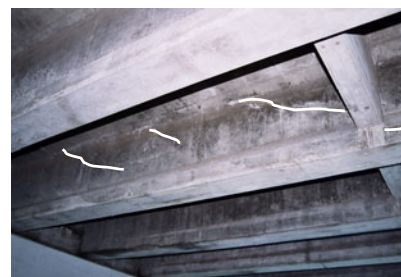
写真-2 主桁ウェブひび割れ
