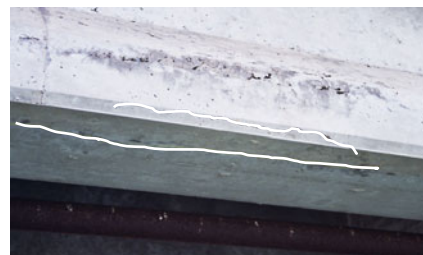
写真-1 主桁下フランジひび割れ
