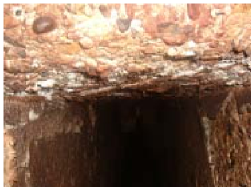
写真-1 流入水路の劣化状況(施工前)
