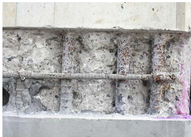
(b)補修箇所の上部の未補修箇所の鉄筋腐食状況（暴露 9 年後の調査時撮影）
