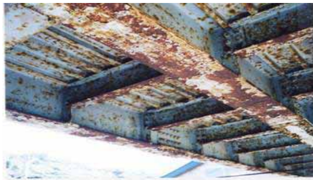
写真-1 乗換えこ線橋床版の腐食状況（例）
