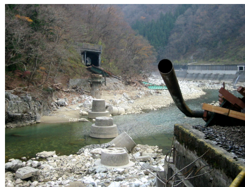
写真-1 第9宮川B被災状況
