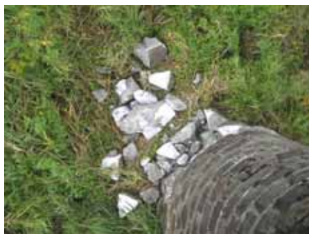
図 - 3 P3 被災状況（躯体下部損傷）
