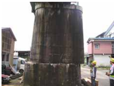
図 - 2 P15 被災状況（躯体下部損傷）
