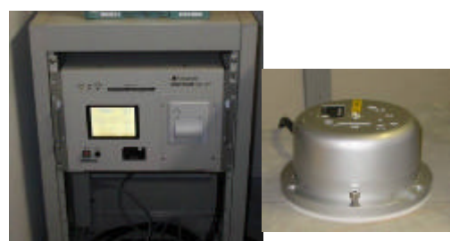
図2 電気式沿線地震計（左：処理装置 右：センサ）
