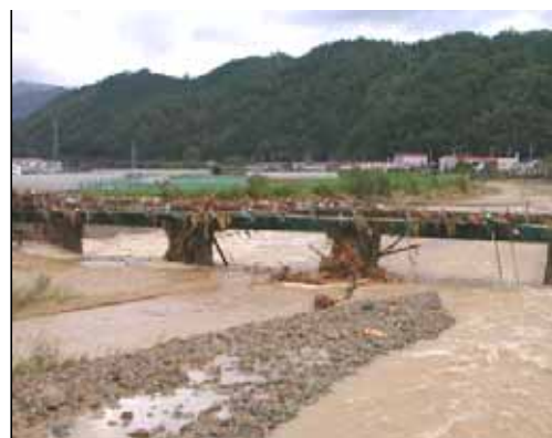
写1 橋桁まで水位が達した高山線の橋りょう
