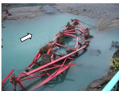
写真-7 小原橋桁の流出状況
