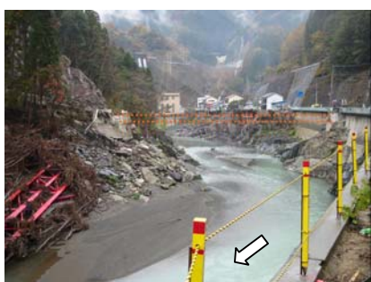
写真-10 尾佐渡橋の被災状況
