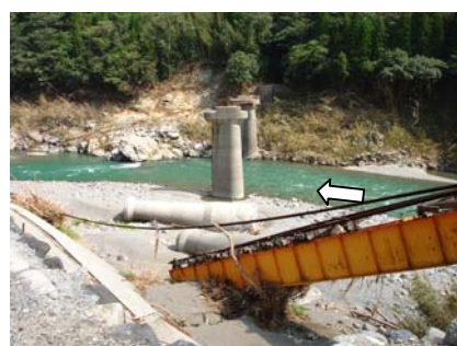
写真-3 第2鉄橋の被災状況
