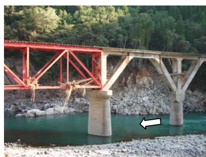
写真-5 第3鉄橋の状況
