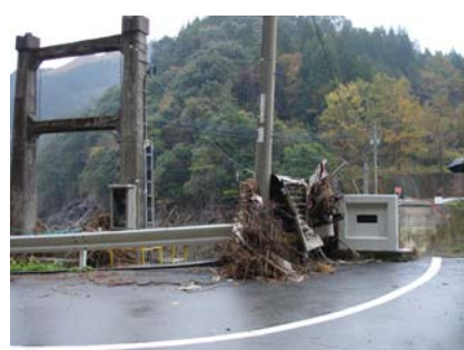
写真-8 小布所橋の被災状況
