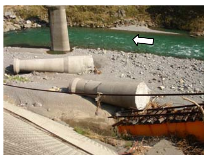
写真-4 第2鉄橋の被災状況
