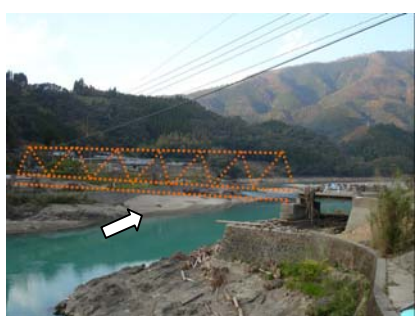
写真-6 小原橋の被災状況
