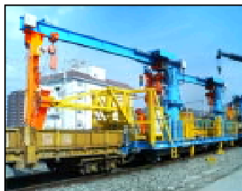
写真1 スラブ交換機(回送時)
