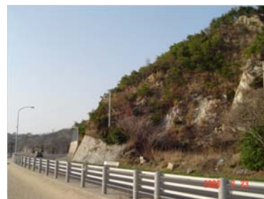
写真-1 被災斜面現状(2006.2.23)
