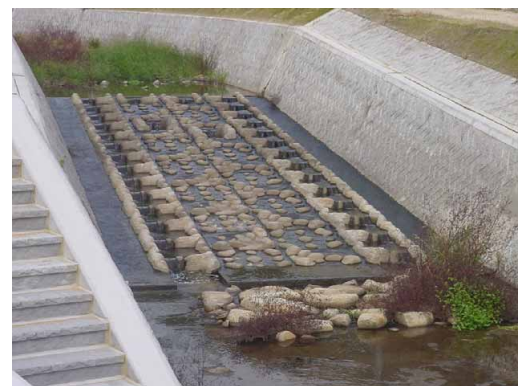
写真-5 河床低下の例
