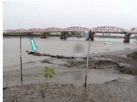
写真-2 石が崩れた荒籠
