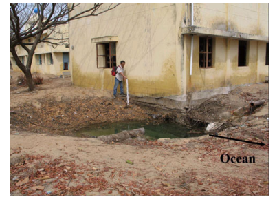
写真-2 スマトラ島沖地震津波による洗掘（出典：Yeh ら）
