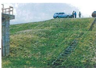
写真-1 B 樋門の抜け上がり
