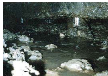
写真-2 C 樋門の底版下空洞
