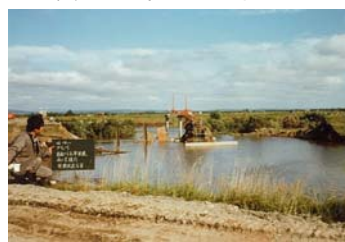
写真-3 D 樋門周辺漏水による決壊
