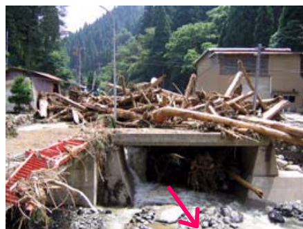
写真-3 ③金見谷川橋の流木状況 *1)
