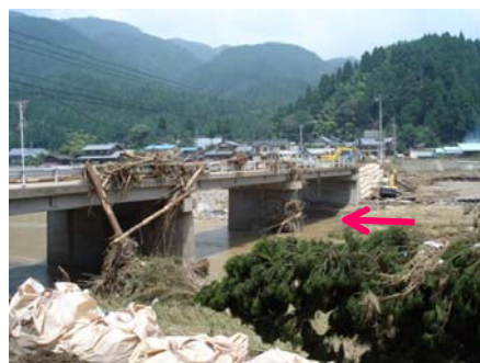
写真-9 ⑧高田大橋の流木状況
