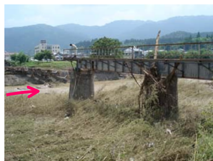
写真-8 ⑦第4鉄橋の流木状況
