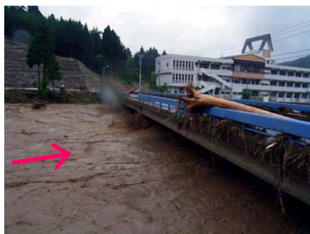
写真-5 ⑤宇坂橋の流木状況 *1)
