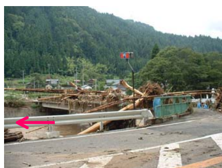
写真-4 ④河原橋の流木状況 *1)
