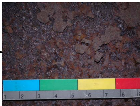
写真-1 W橋下フランジ上面内側の錆の状態
