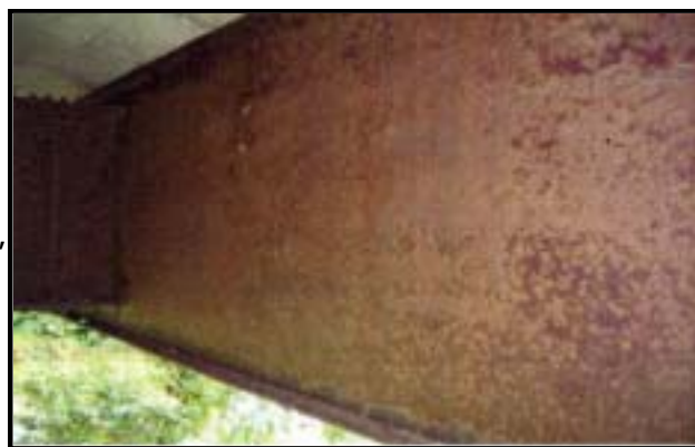
Fig.5 耐候性橋梁の腐食状況の例
