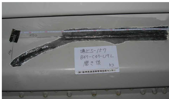
写真-1 き裂状況写真
