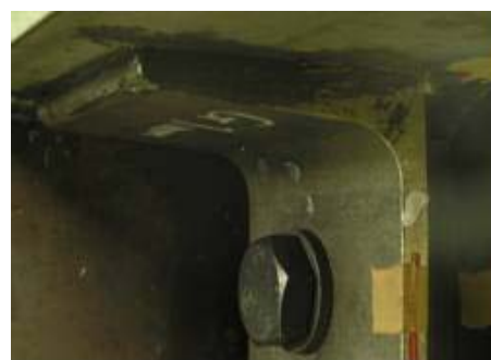
写真1 エポキシパテ密着部
