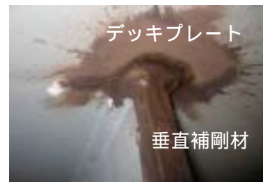
図-1 垂直補剛材上端のき裂
