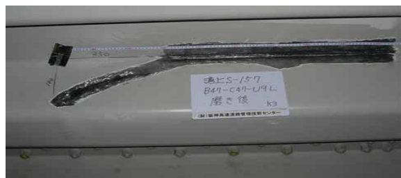
写真-2 Uリブとデッキプレートとの溶接部ビード貫通き裂状況
