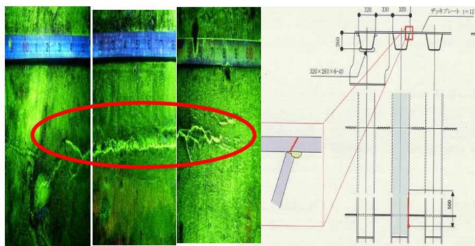
写真-1 磁粉探傷試験によるデッキプレート上面でのき裂状況
