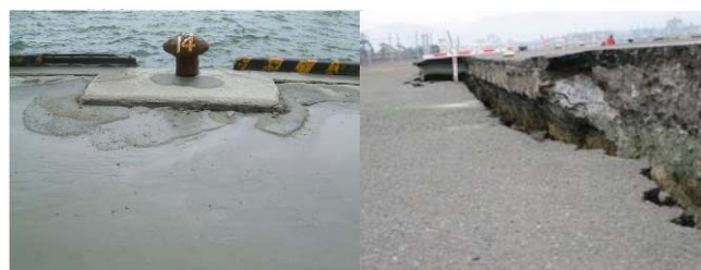
写真-1 液状化による被災状況
